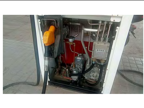
加油机油气回收设施
